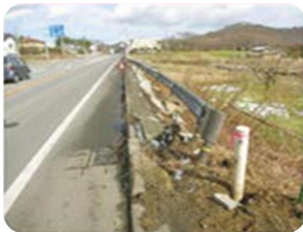
ガードレール・ 標識等の損傷
