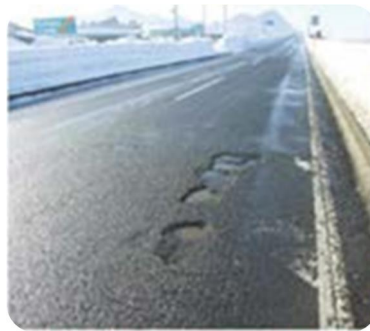
路面の穴ぼこ・ 段差
