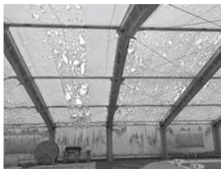
ヒョウにより被害を受けた松伏町B&G海洋センター競技用プールの屋根
