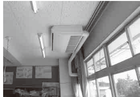
視察先のエアコン設置(天井吊形)
