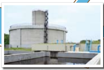
▲築比地浄水場のタンク
