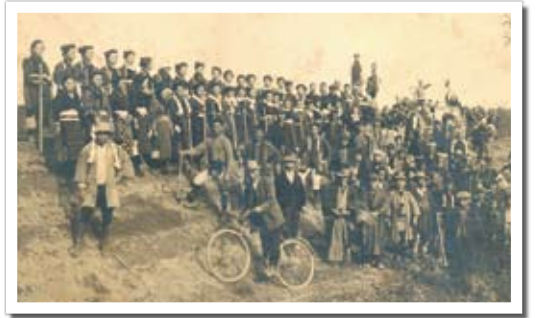
▲明治43年の水害の時の地域住民による古利根川堤防修復工事(寿橋近辺)
