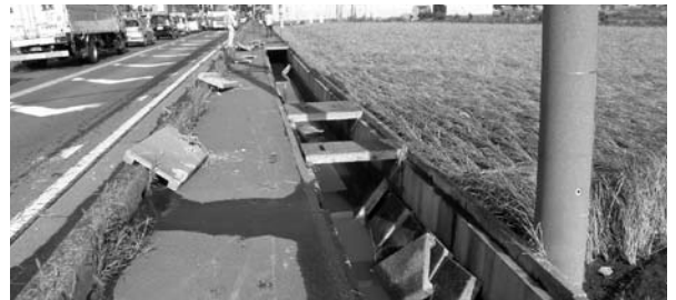
▶吹き飛んだ側溝のふた
