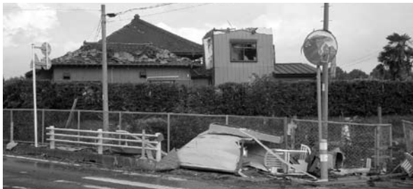
▶ 金杉地区 ▶ 家屋への被害
