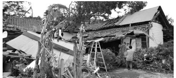
▶家屋への被害 (大川戸地区)
